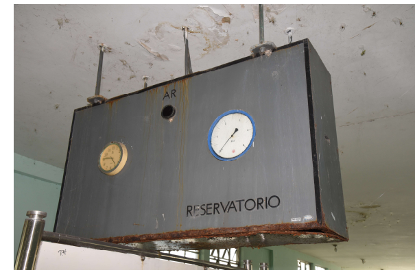
Relógio e Manômetro da Galeria F de Lavagem dos Filtros da VETA
